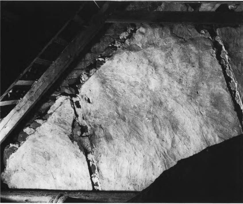
Fig. 4. Nordre halvdel af triumfgavlens vestside med aftryk efter skibets oprindelige \dagger tagværk (s. 1414, jfr. fig. 3). HJ fot. 1985. - Northern half of the east gable of the nave showing traces of the nave's original \dagger roof cf. fig. 3.
